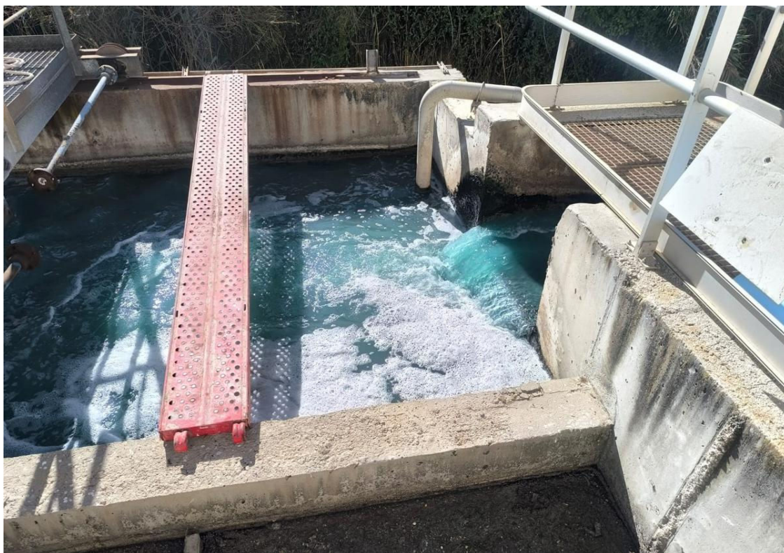
Imagen de la depuradora de Priego m. osuna
